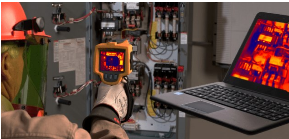
Рисунок 20. Пример проведения тепловизионного контроля электрошкафа
